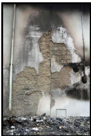
Figura 21 – Spalling do concreto em (a) uma parede externa e (b) na laje de cobertura de uma garagem.
