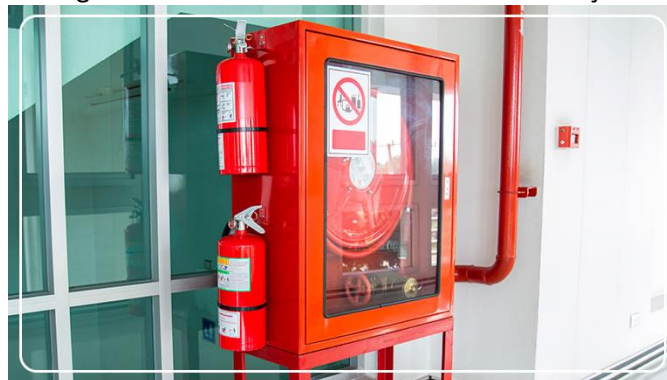
Figura 2 - Hidrante e extintores numa edificação
