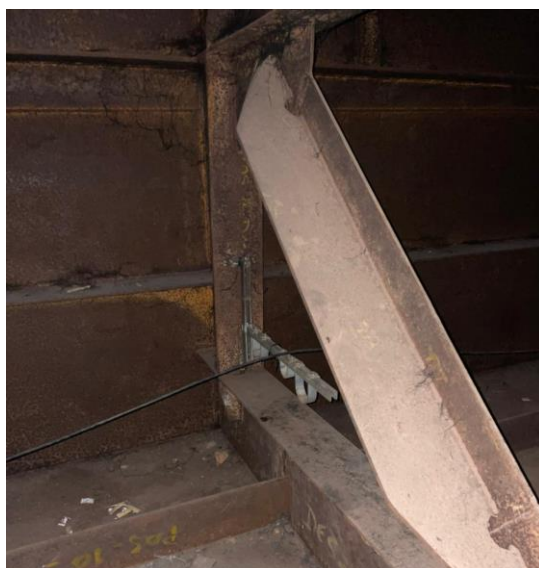
Figura 11 – Detalhe contraventamento, perfil T transversal da mesa inferior, enrijecedores longitudinais e perfil T das paredes. Fonte: Autores.
