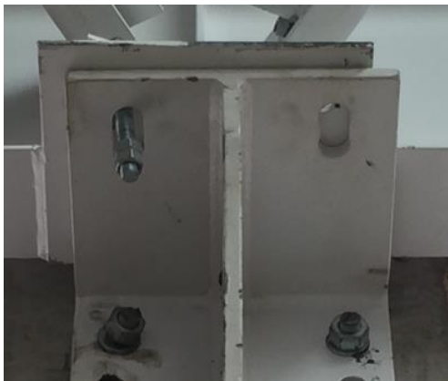
Figura 16 – Falta de parafusos em ligação da estrutura principal – 02
