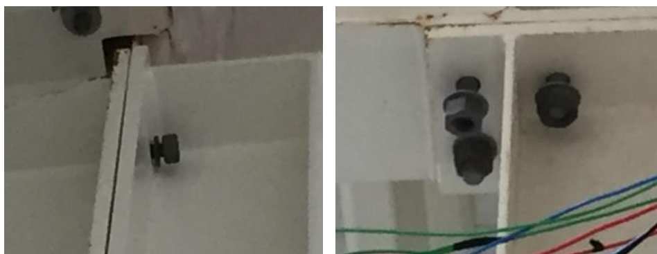
Figura 13 – Falta de aperto normal de parafusos – 03
