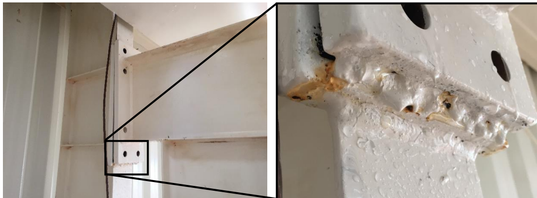
Figura 02 – Execução de solda em detrimento da utilização de parafusos conforme Figura 01
