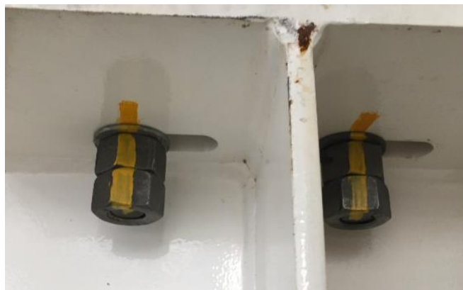
Figura 05 – Desvio no aperto do parafuso com impedimento de movimentação da estrutura
