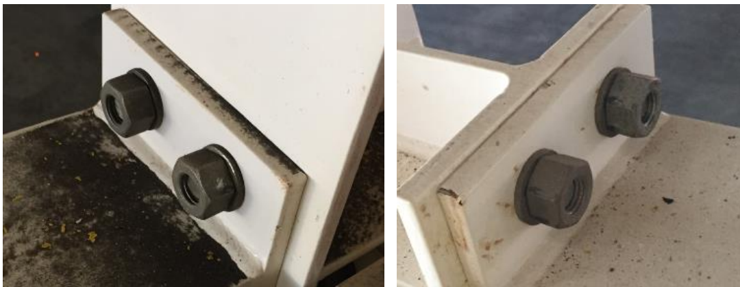
Figura 23 – Comprimento insuficiente de parafuso
