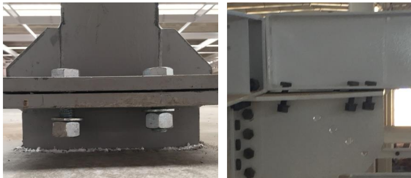
Figura 11 – Falta de aperto normal de parafusos – 01
