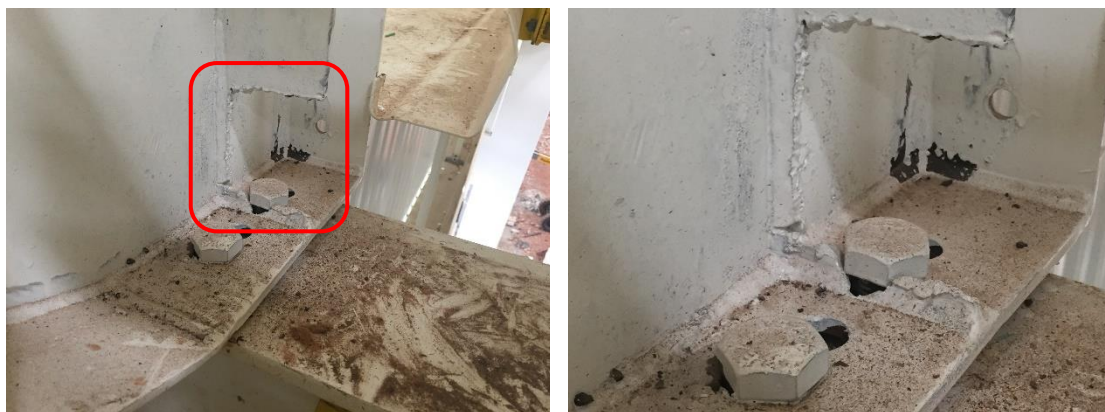
Figura 03 – Falta de linearidade entre furações com corte de enrijecedor e alargamento de furação - 01
