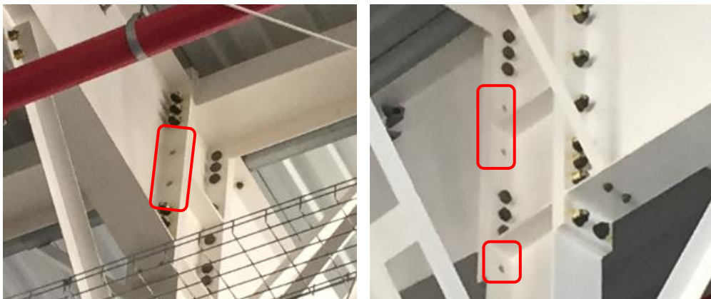
Figura 15 – Falta de parafusos em ligação da estrutura principal – 01
