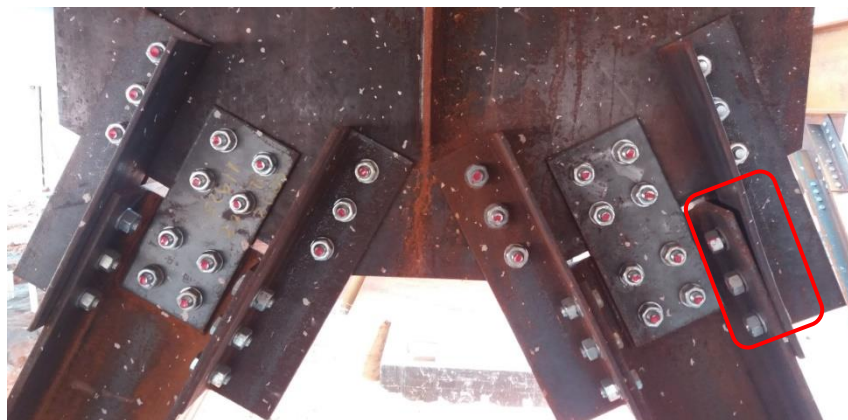
Figura 09 – Deformação em cantoneira de ligação
