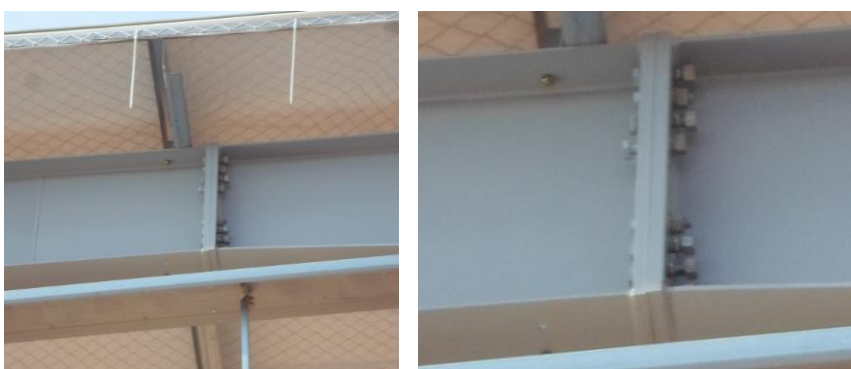
Figura 12 – Falta de aperto normal de parafusos – 02
