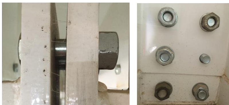
Figura 14 – Falta de aperto normal de parafusos – 04
