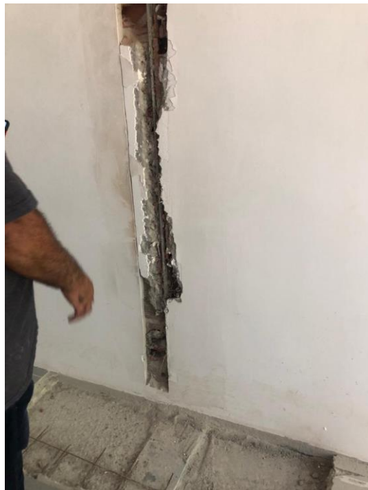
Figura 2 - Local da abertura de fissura na vedação (vista interna).
